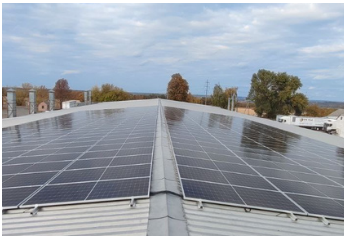
Черкаська область, станція потужністю 179,82 кВт, Розведення свійської птиці
