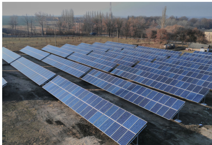
Запорізька область, станція потужністю 600 кВт, Фермерське господарство
