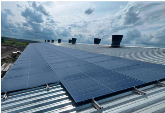
Київська обл, станція потужністю 240 кВт під власне споживання та Net Billing
