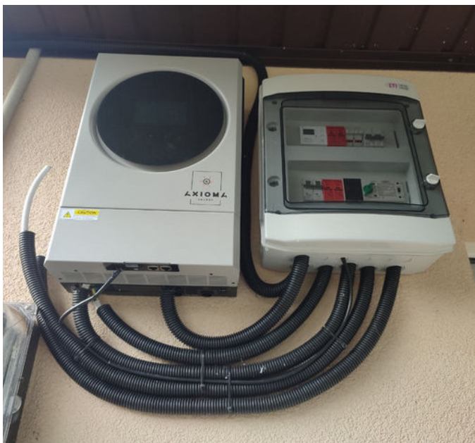
м. Черкаси 6 кВт гібридна СЕС з АКБ на 5,12 кВт
