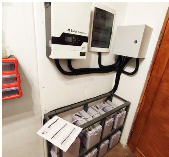
м. Черкаси, 5 кВт гібридна СЕС з АКБ 9,60 кВт
