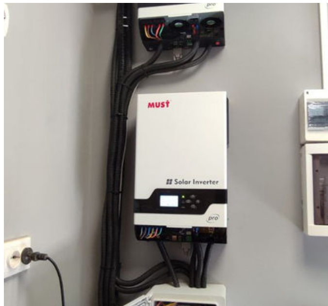
м. Черкаси, 5 кВт гібридна СЕС з АКБ на 4,80 кВт
